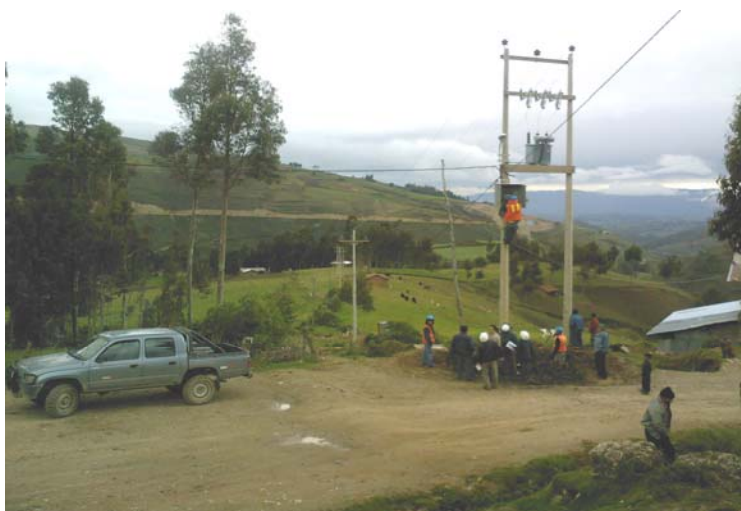
Inspección de Transformador y Tablero Localidad Michiquillay – distrito La Encañada Provincia y Departamento de Cajamarca
