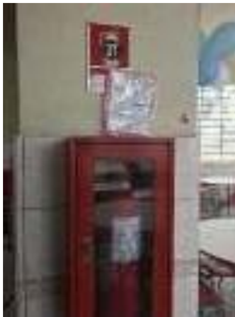
Foto N° 76. Extinguidor para el área del comedor del hospital
