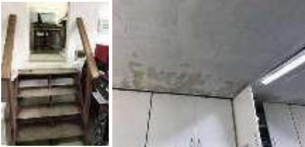
Foto N° 44. Mal estado de las instalaciones del centro de salud
