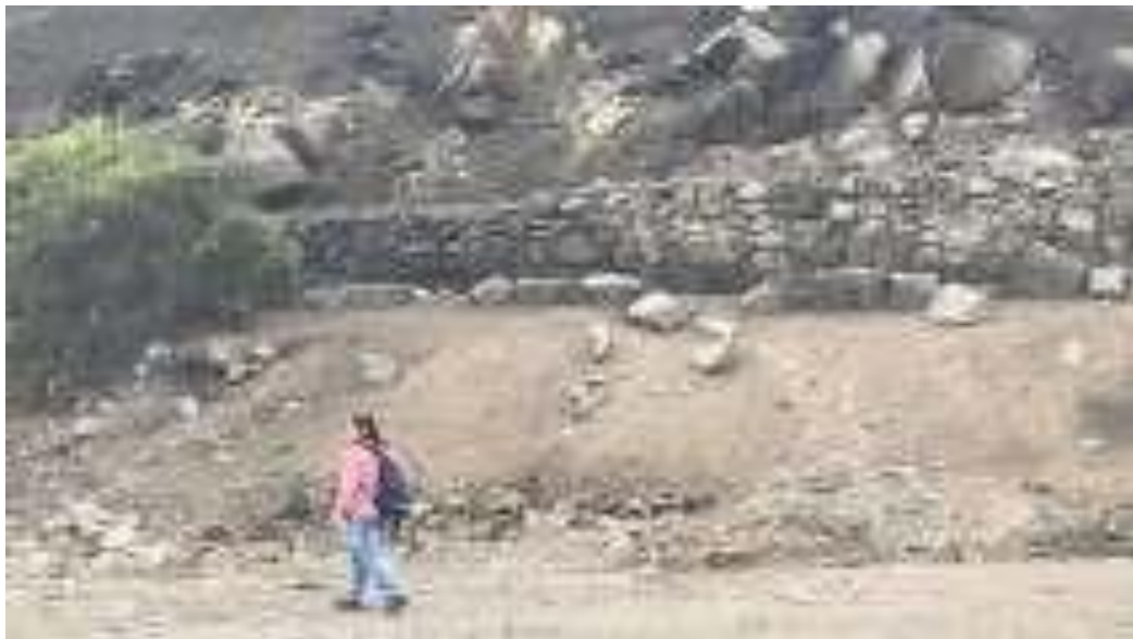
Foto N° 92. Vista de la muralla que rodea el cerro, en la parte más baja de la Z.A.M. “Fortaleza de Collique”
