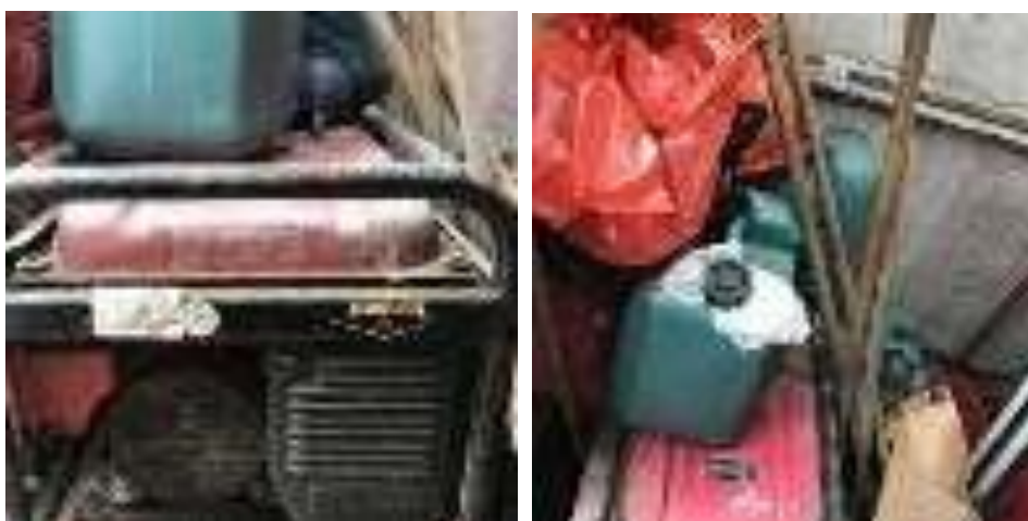
Foto N° 30. Generador eléctrico del área de consultorios del CMI
