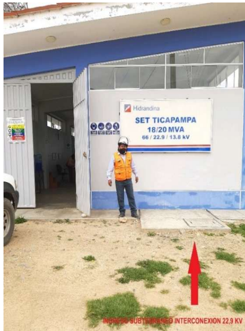
Figura N°3: Punto de Interconexión, Inicio con Cable Subterráneo
