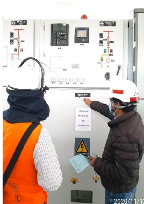
Figura N° 4: Punto de Interconexión, Inicio en Celda de Reserva
