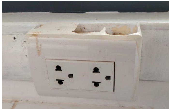
Figura 5. Estado actual de los tomacorrientes en la sala de trabajo del laboratorio.
