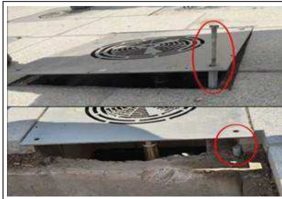
Imagen n.° 20 Rejillas del juego de aguas 1 y 2
