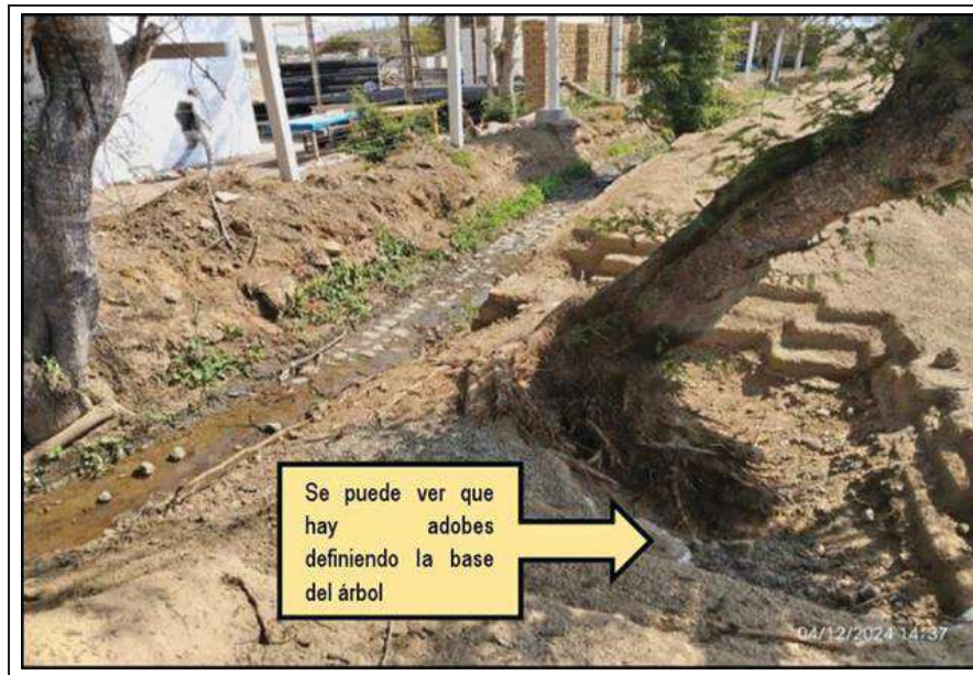
Imagen n.º 04 Imagen de un árbol encima del muro perimetral del conjunto amurallado
