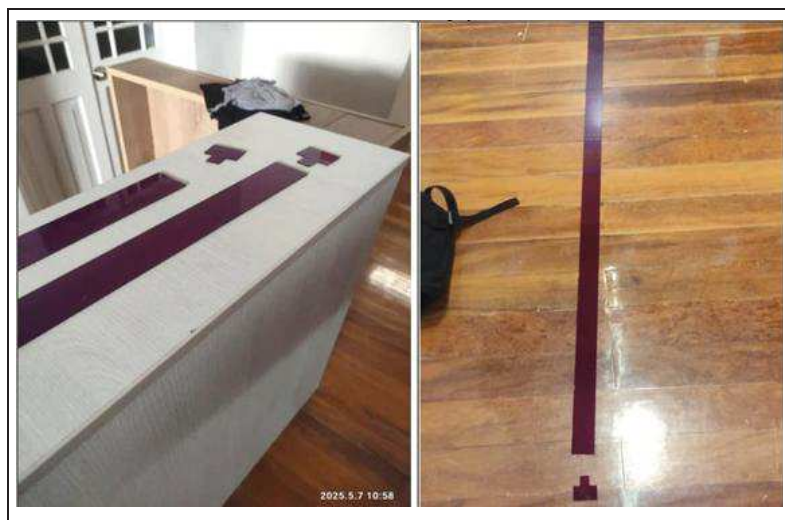
Imagen n.º 15 Tiras de acrílico caídas y quebrados
