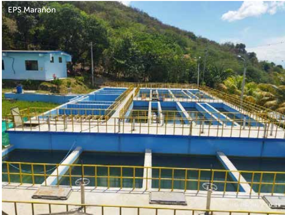
Imagen 7. Planta nueva de tratamiento de agua potable de la ciudad de Jaén
