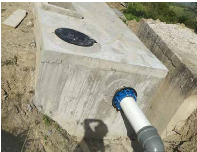
Imagen 14. Cámara e instalación de válvulas de aire.
