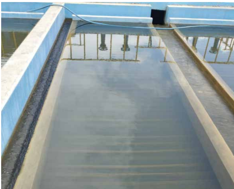
Imagen 13. Instalación de vinilonas en el componente de decantación y pantallas de PVC para componentes de floculación en PTAP.
