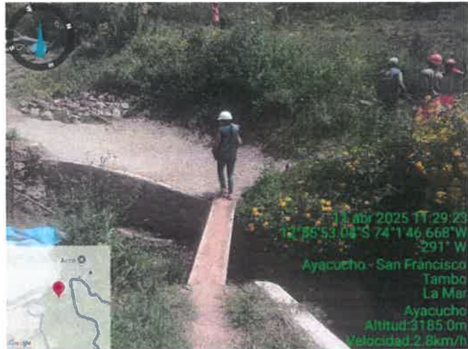
Imagen: Falta de señalética aledaña en tramo de la obra.
