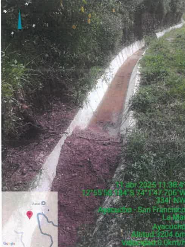
Imagen: Se observa las deficiencias de la obra, causadas por la falta de atención oportuna a razón de la falta de asignación presupuestal.
