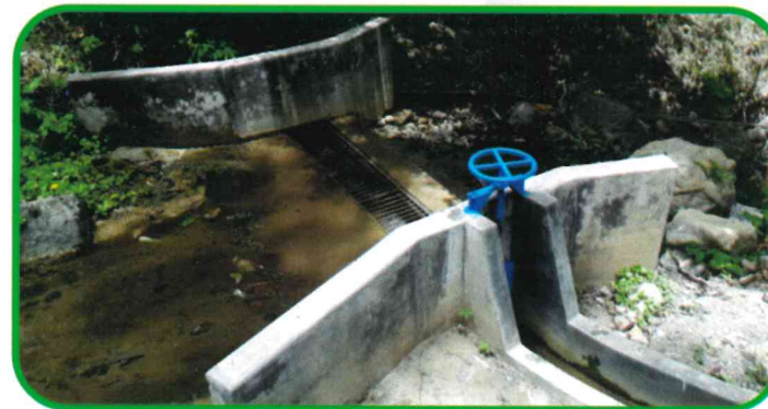
FOTO N 09: Operación de la Captación – Tonccopara
