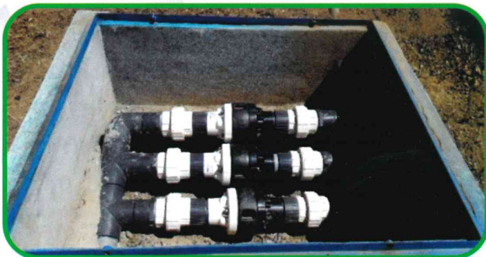
FOTO N 19: Reguladora de presión - Totora
