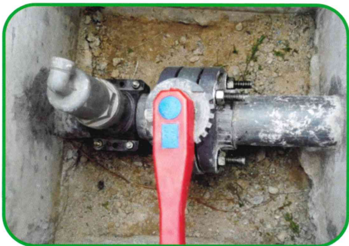
FOTO N 17: Válvula de Control principal – Totora
