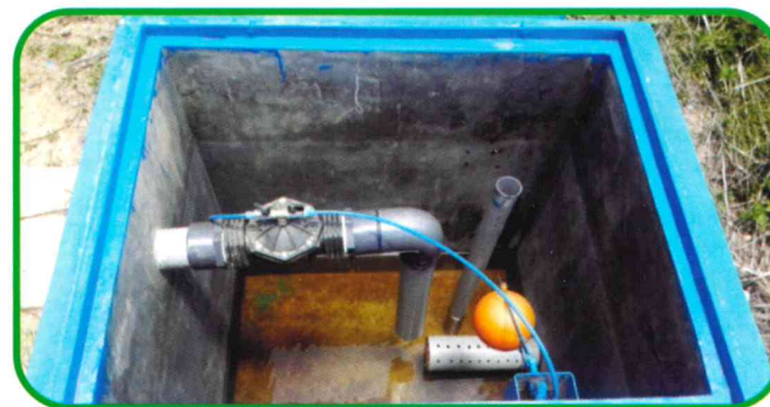
FOTO N 18: Cámara Rompe Presión con control de nivel – Totora
