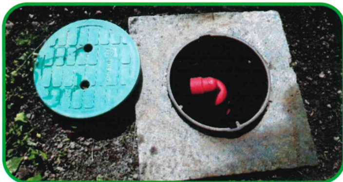
FOTO N 20: Válvula de Aire - Willana
