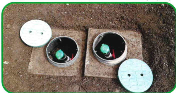
FOTO N 23: Toma de hidrante – Willana
