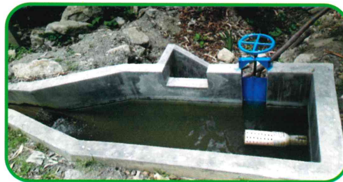
FOTO N 10: Operación del desarenador – Tonccopara
