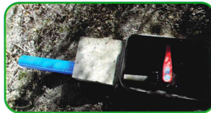
FOTO N 21: Válvula de purga principal - Willana
