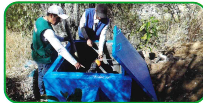
FOTO N 27: Mantenimiento de válvulas hidráulicas de la Cámara Rompe Presión Cada beneficiario debe controlara las presiones de operación en cada arco de riego instalando el manómetro en el punto de toma manométrica
