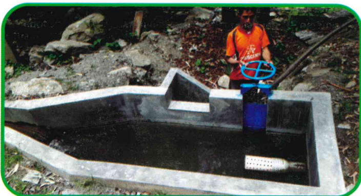
FOTO N 02: Operación del desarenador– Tonccopara
