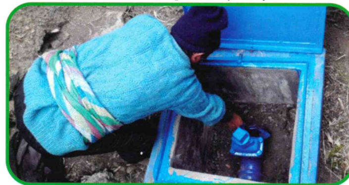
FOTO N 13: Válvula de control del Reservorio de Willana
