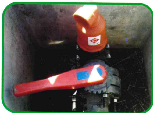
FOTO N 05: Válvula de control – Willana
