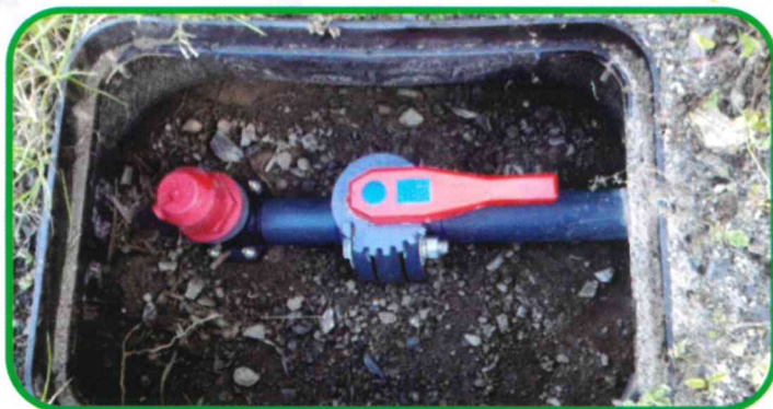
FOTO N 22: Válvula de control distribuidora – Willana
