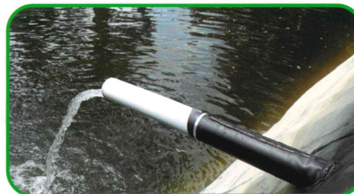
FOTO N 04: Tubería que viene desde el desarenador – Tonccopara
