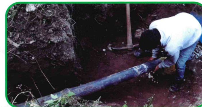
FOTO N 16: Tubería principal de PVC
