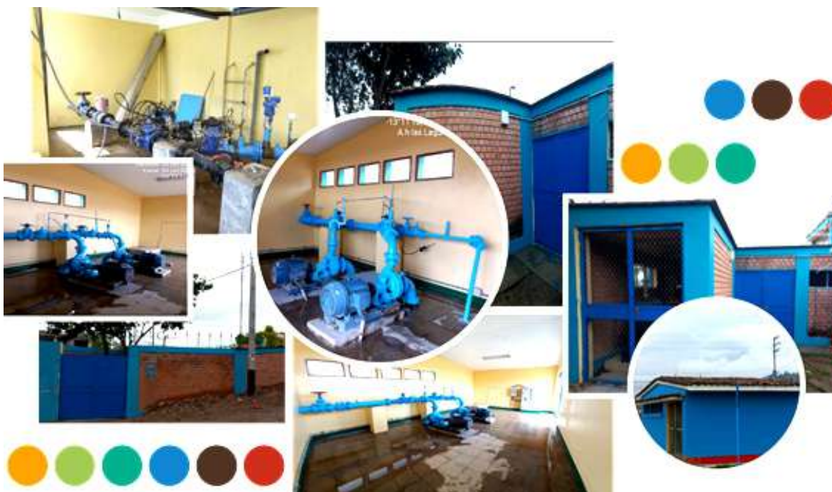
Imagen N° 33 Capacidad instalada en las estaciones de bombeo
