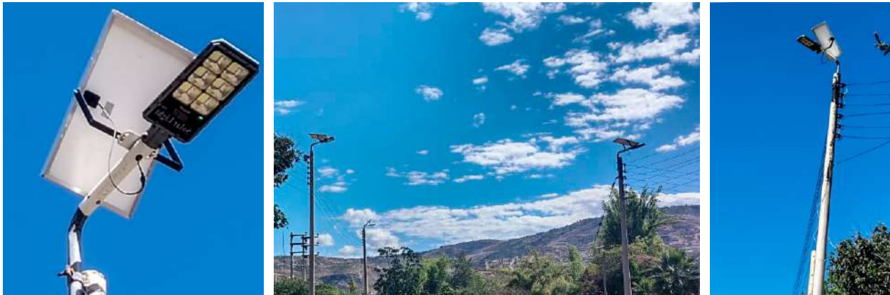
Imagen N° 35 Apostando por una energía limpia: Innovación en el alumbrado público de la PTAR con paneles solares led-400 watts
