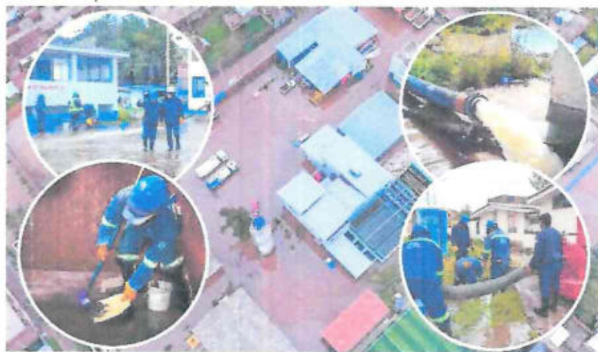
Desborde del río Jayllhuaya afecta el suministro de agua en Puno. EMSA Puno activa contingencia para limpiar cisternas contaminadas y restablecer el servicio lo antes posible
