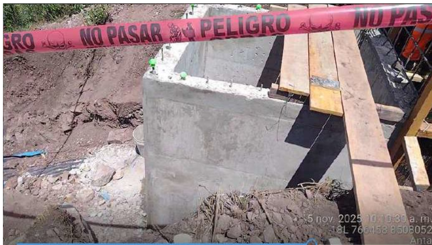
Figura N°15: En Bocatoma Cauce estrecho y remoción de suelos en ladera del flanco derecho
