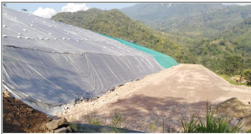
Imagen N° 5.- Toldos y mallas repuestos
