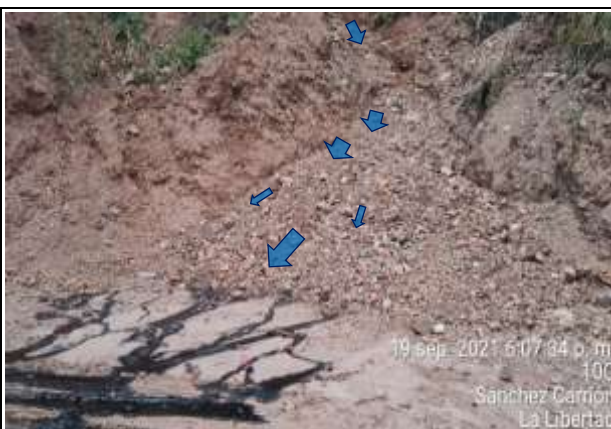
Imagen N° 25: Afloramiento de emulsión asfáltica proveniente del discurrir por debajo de material sedimentario de un área socavada a una cota superior a 60 m aproximadamente
