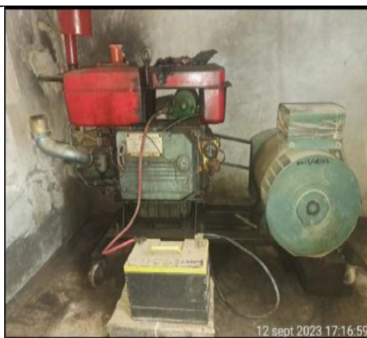
Foto N° 25: Fotografía fechada del grupo electrógeno dentro del cuarto de máquinas, no se encuentra encapsulado.
