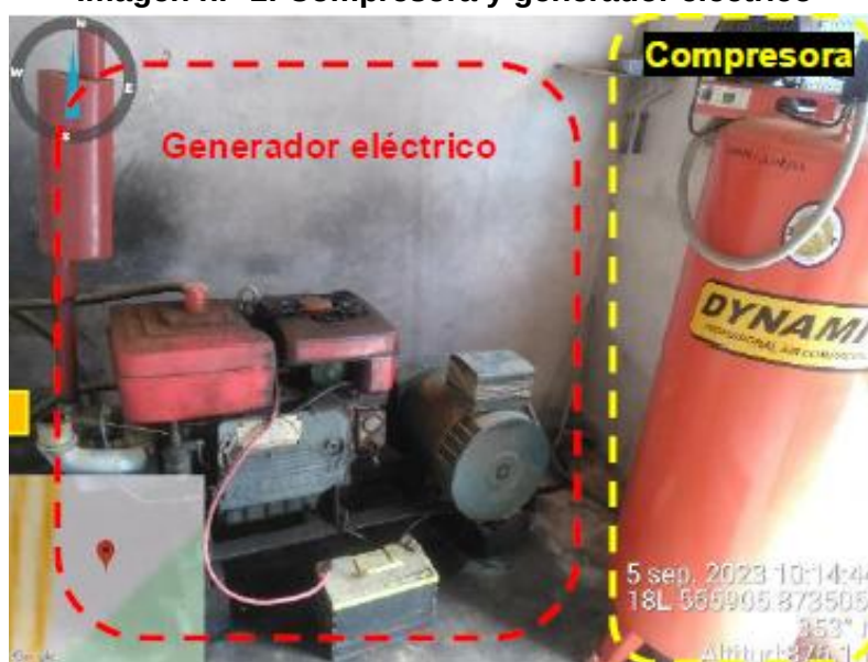
Imagen n.º 1: Compresora y generador eléctrico
