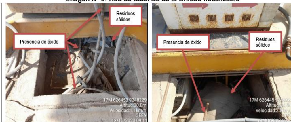
Imagen N° 9-A 38 : Fotografía donde se observa parte de las tuberías conectadas a los dispensadores de CL.
