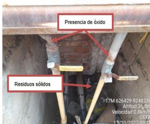
Imagen N° 9-C 40 : Fotografía donde se observa parte de las tuberías conectadas a los dispensadores de GLP.
