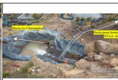
Fotografía N° 32. Archivo TimePhoto_20240314_100807, se observa desde el otro extremo (lado opuesto del acceso) que 11,02 l/s son descargados por el canal de geomembrana al río Chacapalca y solamente 0,87 l/s es derivado por la tubería HDPE de 6" hacia su tratamiento.
