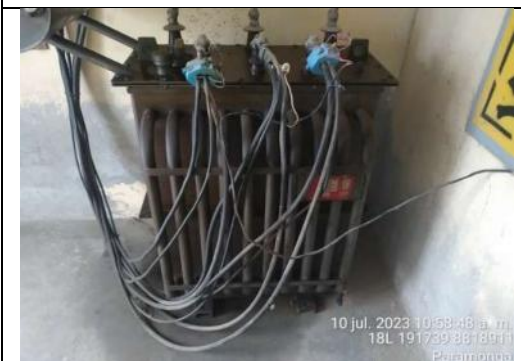
Fotografía n.º 17: Estructura metálica del transformador cubierta de sustancias oleosas y/o aceitosas (hidrocarburos).
