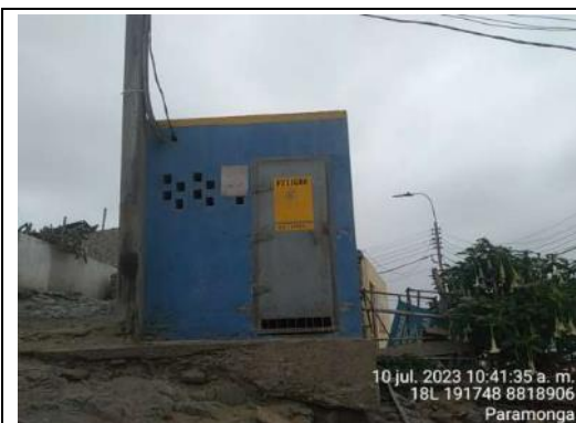
Fotografía n.º 13: Subestación Convencional SC 13056 del Alimentador n.º 03.
