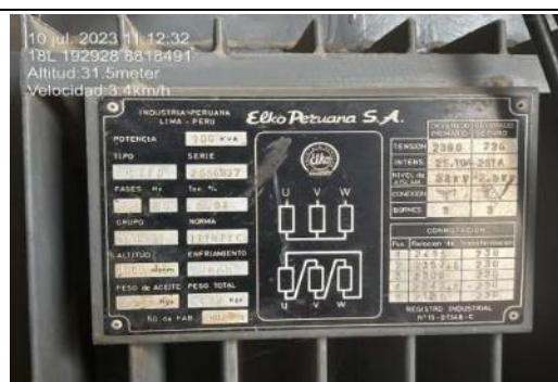
Fotografía n.º 12: Placa técnica del Transformador de potencia
