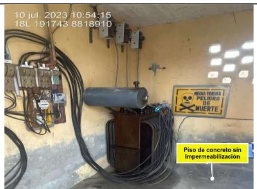
Fotografía n.º 15: Transformador de potencia 100kVA, de la Subestación Convencional SC 13056 del Alimentador n.º 03.
