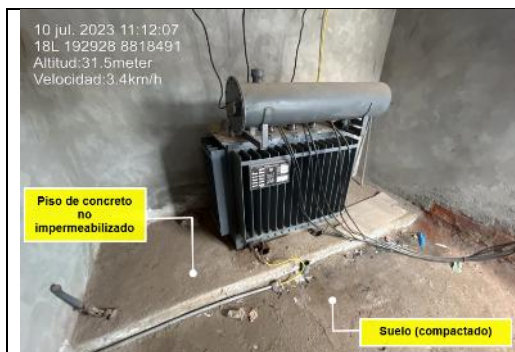
Fotografía n.º 11: Área donde se encuentra el transformador, no cuenta con un sistema de contención frente a posibles derrames y/o fugas de sustancias oleosas
