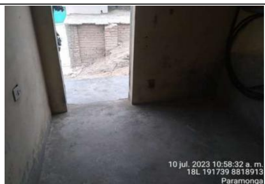
Fotografía n.º 20: En el área donde se ubica el transformador, se observó el piso de material concreto, sin ningún sistema de contención, ni impermeabilización.
