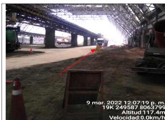
FOTOGRAFÍA N° 3.- Se observa la presencia de camiones que ingresaban al área de almacenamiento de concentrados.
