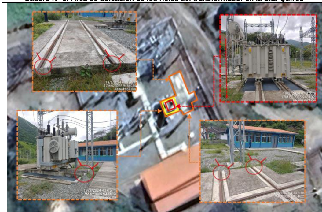
Cuadro N° 6: Área de ubicación de los rieles del transformador en la S.E. Quiroz
