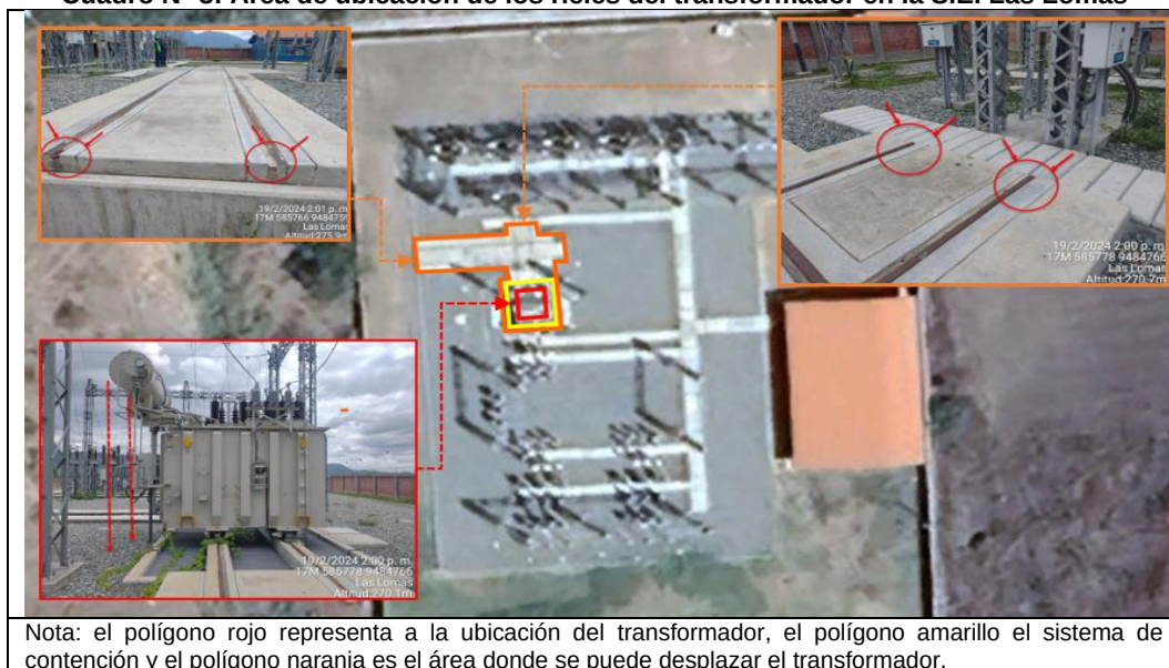
Cuadro N° 3: Área de ubicación de los rieles del transformador en la S.E. Las Lomas
