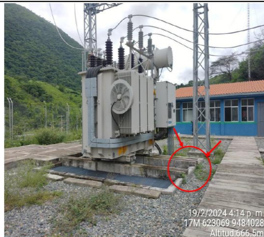
Fotografía N°6 del Informe de Supervisión: Vista del transformador trifásico de potencia de 15 MVA de marca ABB, que se encuentra parcialmente sobre cubetos de contención de concreto con reja metálica.
