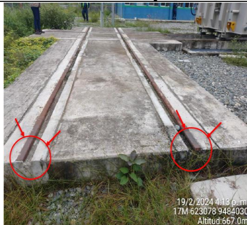
Fotografía N°7 del Informe de Supervisión: Vista de extremos de los rieles metálicos que sirven para movilizar el transformador, estos no tienen barrera de contención en caso de derrame y/o fuga.
