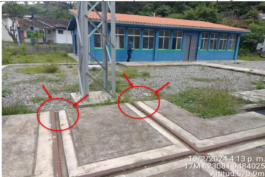
Fotografía N°8 del Informe de Supervisión: Vista de los extremos de los rieles metálicos que sirven para movilizar el transformador, estos no tienen barrera de contención en caso de derrame y/o fuga.
