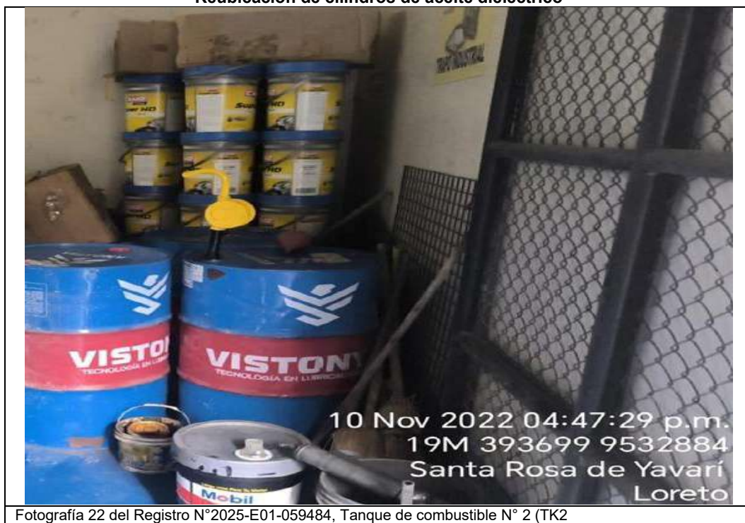
Fotografía 22 del Registro N°2025-E01-059484, Tanque de combustible N° 2 (TK2)
