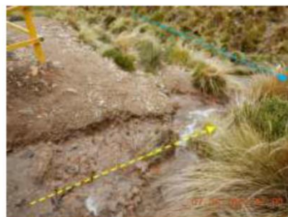
Fotografía 20. Vista del discurrimento sobre el suelo hasta llegar a la quebrada Pumahuasi, la cual está cubierta con vegetación. Fuente: Archivo DSCN8370.
