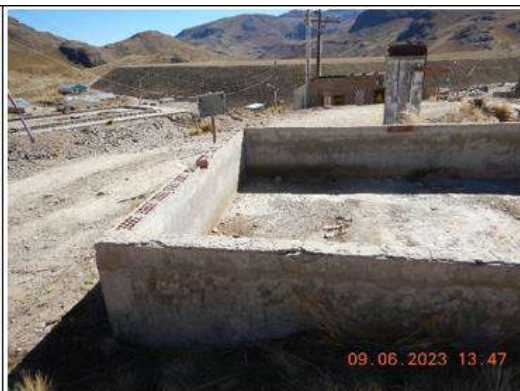
Fotografía N° 69. (DSCN0440) Otra vista de la zona de almacén de combustibles con la zona de contención
