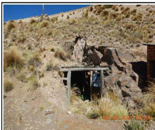
Fotografía N° 80. (DSCN0139) Polvorín, ubicado en la bocamina BOC-06, presenta puesta de rejas metálicas
