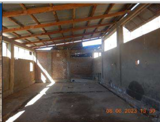
Fotografía N° 77. (DSCN9949) vista del interior de la casa compresora con piso de concreto y residuos de hidrocarburo
