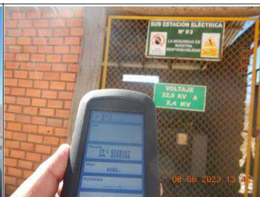
Fotografía N° 83. (DSCN9981) Otra vista de la sub estación eléctrica mina, se aprecia la puerta metálica con mall, letreros.
