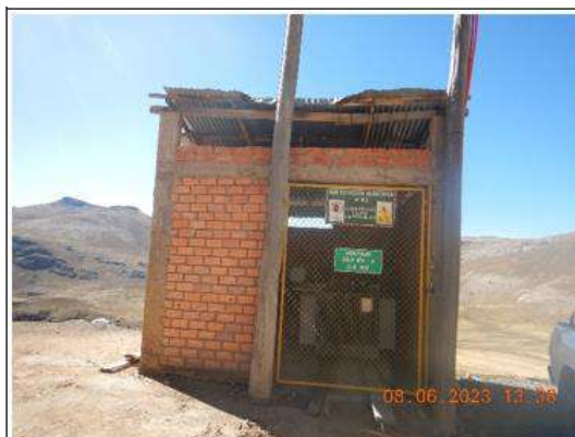
Fotografía N° 82. (DSCN9946) vista de la sub estación eléctrica de mina, donde se aprecia el transformador
