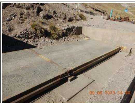
Fotografía N° 75. (DSCN0599) Otra vista de la balanza hidráulica
