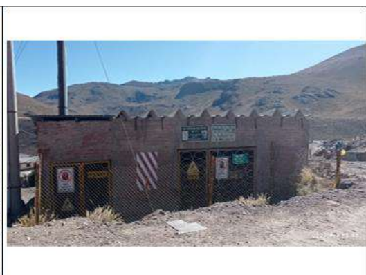
Fotografía N° 85. (IMG_20230609_134002) otra vista de la sub estación eléctrica planta
