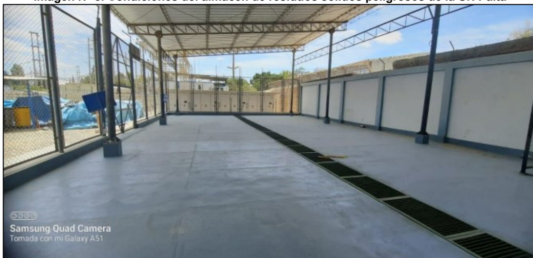
Imagen N° 3. Condiciones del almacén de residuos sólidos peligrosos de la UN Paita
