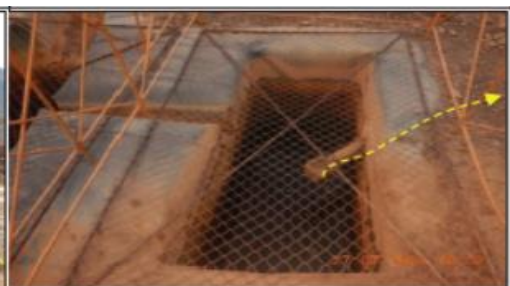
Fotografía N° 2215 40 : Se observó las tuberías de rebose para la derivación hacia el canal que sale del sistema de tratamiento de agua de mina Nv. 0.
