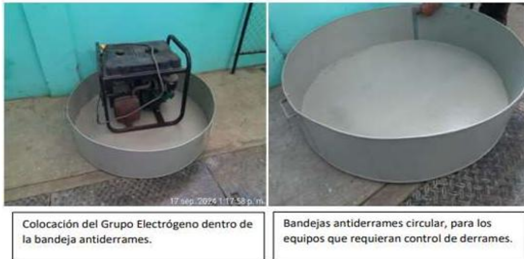
Imagen N° 2. Evidencias fotográficas del sistema de contención del grupo electrógeno
