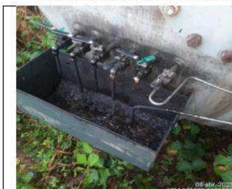
Foto N° 1: Válvulas manipuladas sin precintos
