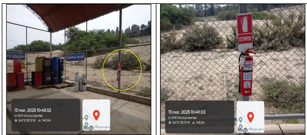
Imagen N° 7: Implementación de extintor de polvo químico seco (PQS) con su respectiva señalización en el almacén de residuos sólidos
