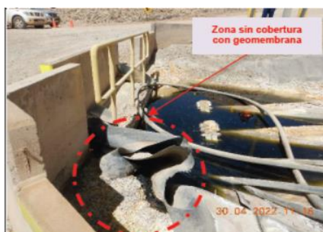
Fotografía N° 11. Vista del dique donde la geomembrana no cubre la superficie de la berma que forma el canal de contención y permite una filtración hacia el acceso. (Código DSCN4298).
