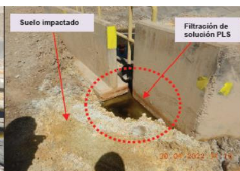
Fotografía N° 12. Vista a detalle de la filtración de solución PLS del canal de contención hacia el acceso (suelo industrial). (Código DSCN4297).
