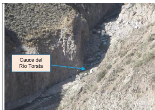
FOTOGRAFIA N° 16.- Continuación de la vista contenida en la Fotografía 15, en la que no se observa ninguna estructura de retención de sólidos y sedimentos.
