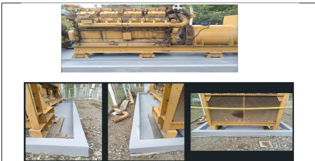
Fig. 03 Informe Técnico DG-025-05-2023-ENOSA. Impermeabilización de contención de Grupo Electrónico CAT.
