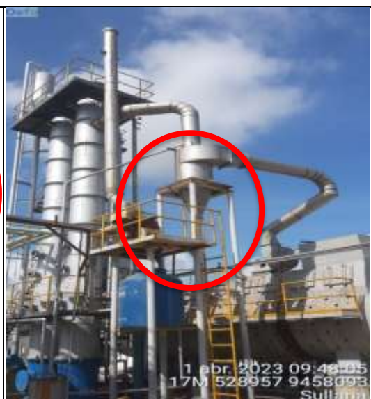
Fotografía N° 2: Vista externa de la planta evaporadora de agua de cola. En el círculo en rojo (chimenea), se observa que no cuenta con un sistema de condensación de emisiones.
