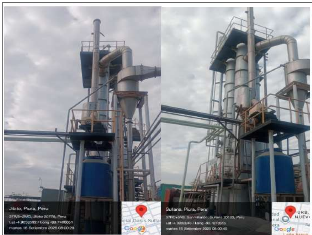
Imagen 03 y 04: Lavador de vahos
