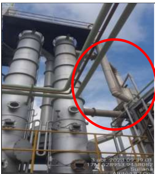
Fotografía N° 1: Vista interna de la planta evaporadora de agua de cola. En el círculo en rojo (chimenea), se observa que no cuenta con un sistema de condensación de emisiones
