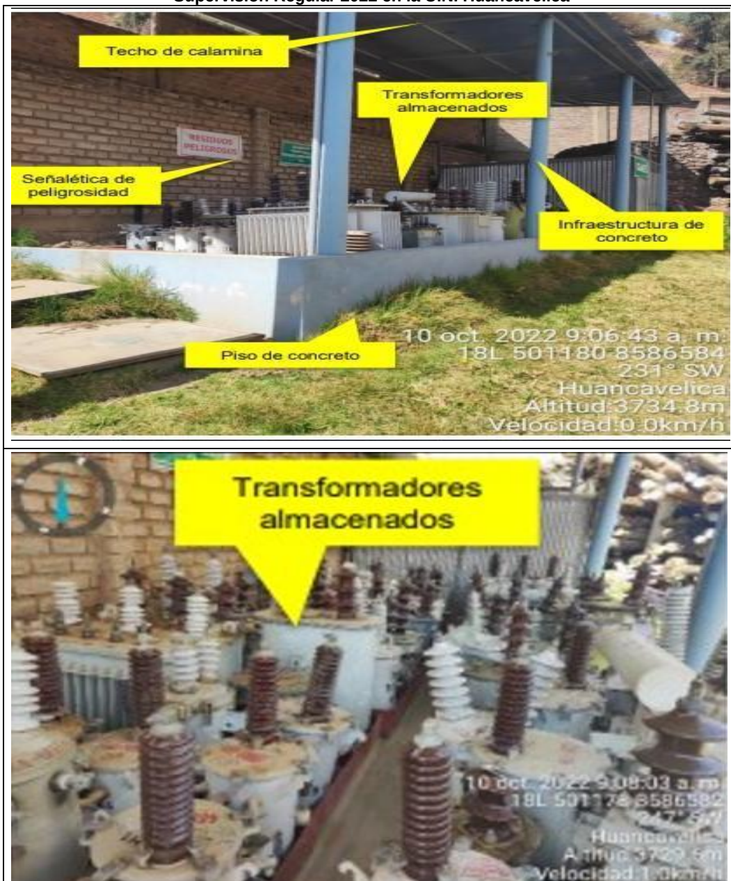
Imagen N° 6: Transformadores en condición de chatarra observados por la DSEM durante la Supervisión Regular 2022 en la U.N. Huancavelica
