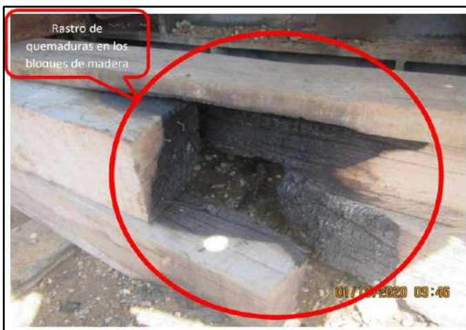
Se observa el rastro del amago de incendio en los cuatro (4) bloques de maderas que soportan la chatarra.
