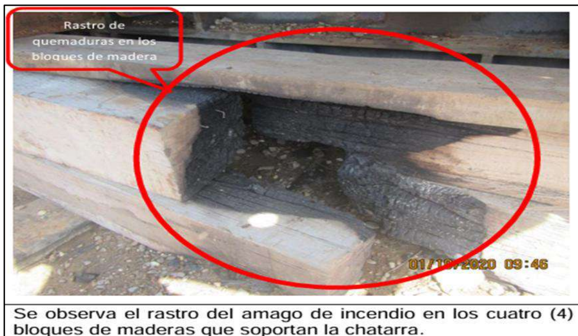
Imagen N° 2: Rastro de quemaduras en los bloques de maderas
