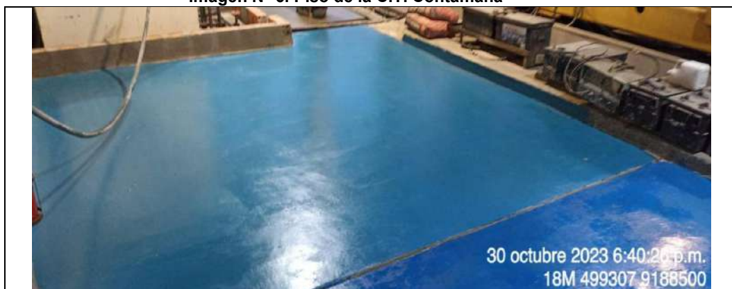
Imagen N° 6. Piso de la C.T. Contamana
