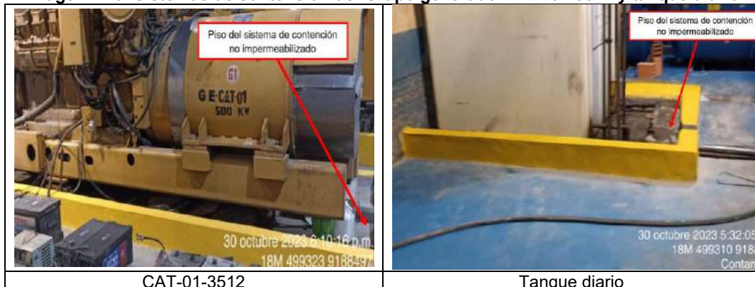
Imagen N° 9. Sistemas de contención del Grupo generador CAT-01-3512 y tanque diario
