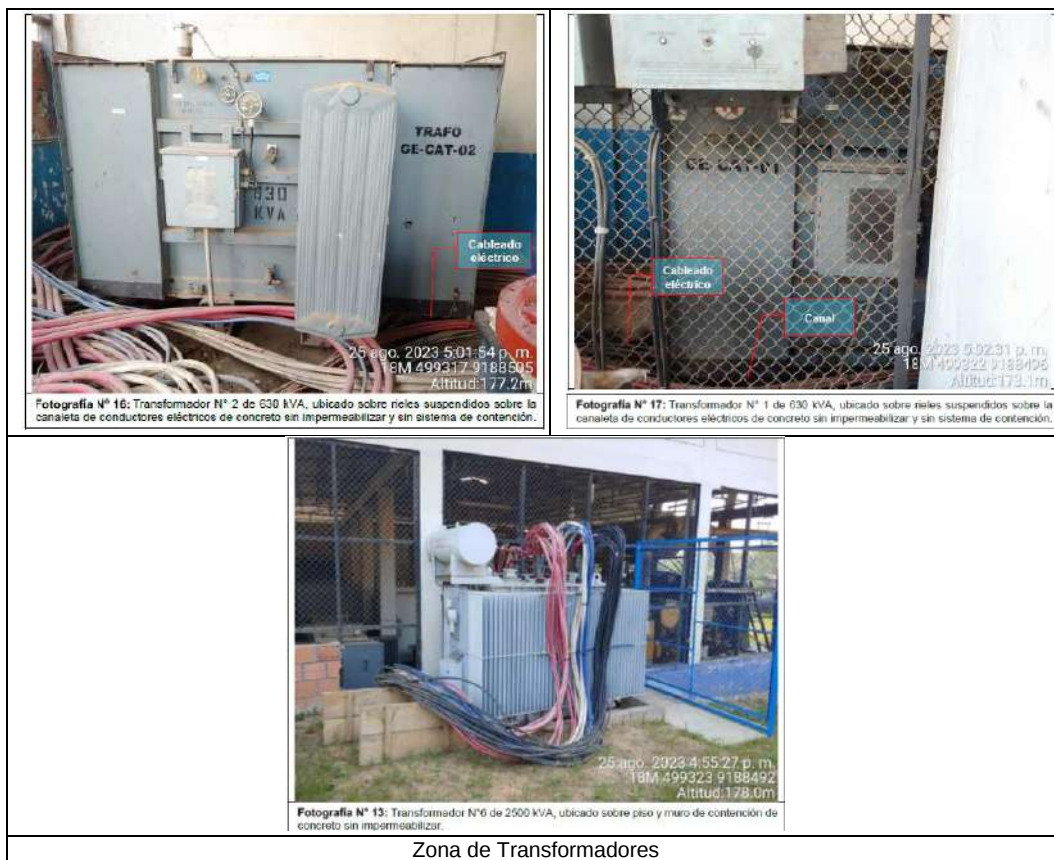
Zona de Transformadores
