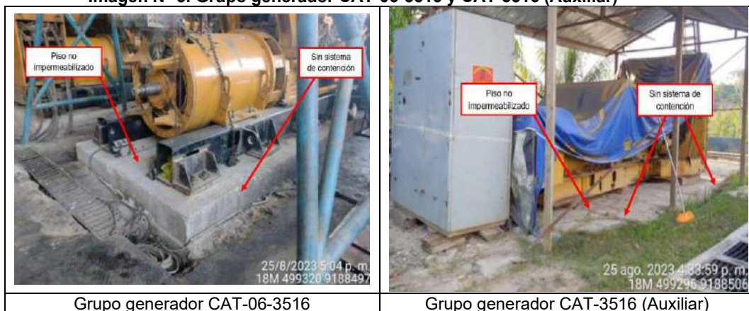
Imagen N° 3. Grupo generador CAT-06-3516 y CAT-3516 (Auxiliar)
