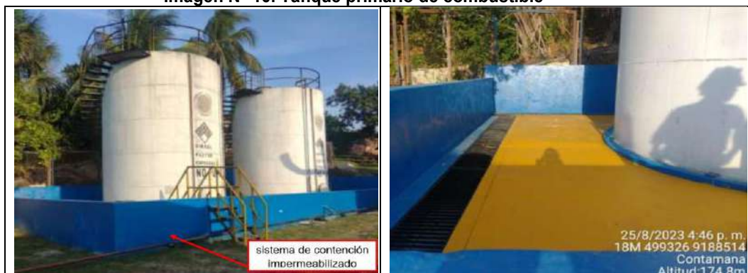
Imagen N° 10. Tanque primario de combustible
