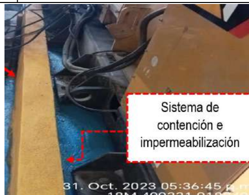
Fotografía N° 6 del Registro N°2025-E01-080290 Después de las medidas , Grupo generador CAT-08-3516, con sistema de contención y piso impermeabilizado de la casa de fuerza.
