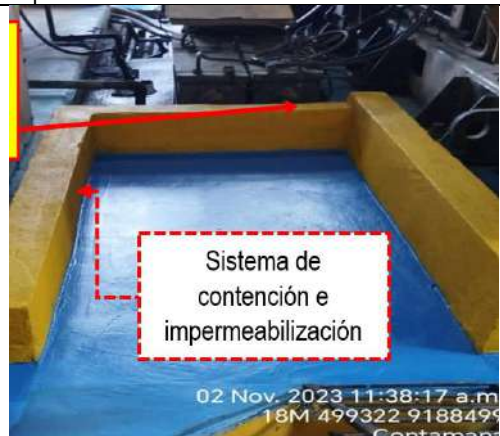
Fotografía N° 8 del Registro N°2025-E01-080290 Después de las medidas , Grupo generador CAT-06-3516, con sistema de contención y piso impermeabilizado de la casa de fuerza.
