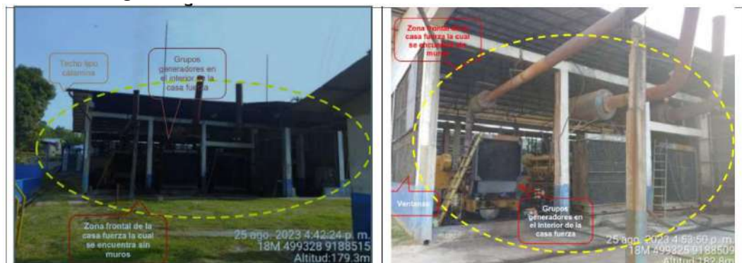
Figura n.º 4: Estado del sistema de atenuación acústica
