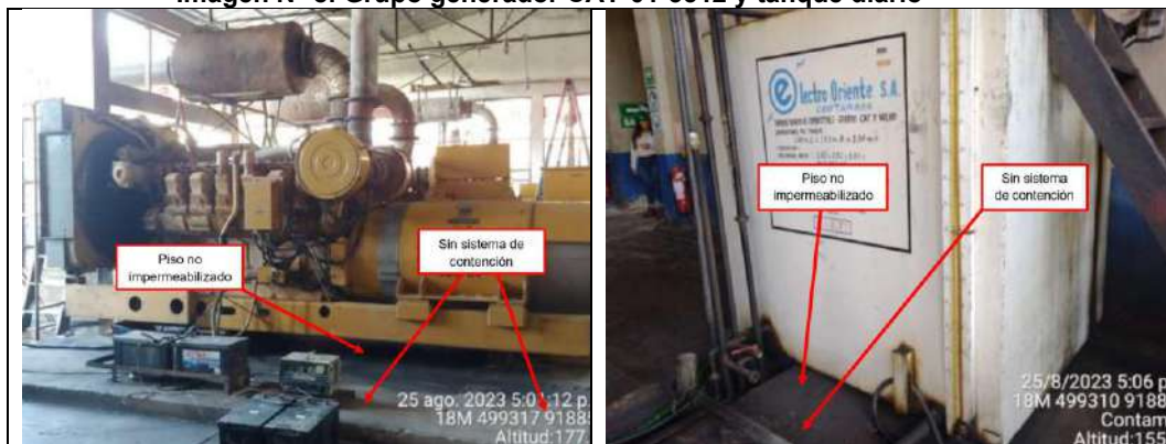
Imagen N° 8. Grupo generador CAT-01-3512 y tanque diario
