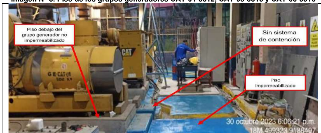
Imagen N° 5. Piso de los grupos generadores CAT-01-3512, CAT-08-3516 y CAT-06-3516
