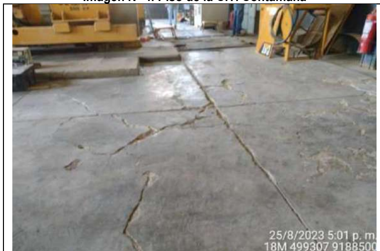
Imagen N° 4. Piso de la C.T. Contamana
