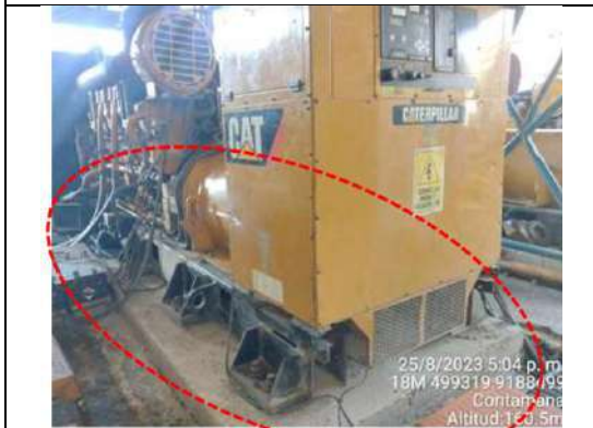
Fotografía N° 5 del Registro N°2025-E01-080290 Antes de las medidas , Grupo generador CAT-08-3516, sobre piso de concreto sin impermeabilizar y sin sistema de contención
