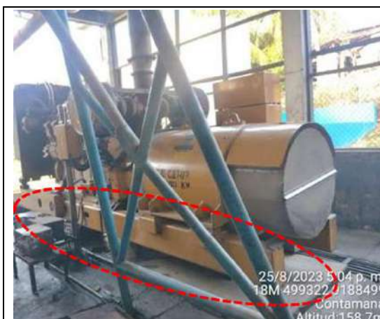
Fotografía N° 3 del Registro N°2025-E01-080290 Antes de las medidas , Grupo generador CAT-02-3512, sobre piso de concreto sin impermeabilizar y sin sistema de contención
