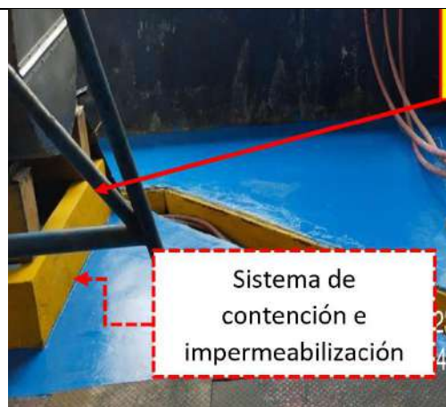
Fotografía N° 4 del Registro N°2025-E01-080290 Después de las medidas , Grupo generador CAT-02-3512, con sistema de contención y piso impermeabilizado de la casa de fuerza.
