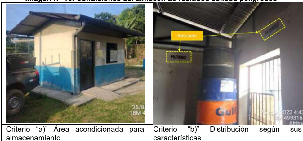
Imagen N° 15. Condiciones del almacén de residuos sólidos peligrosos
