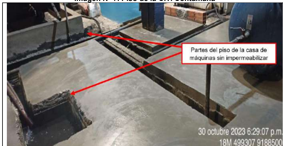
Imagen N° 7. Piso de la C.T. Contamana
