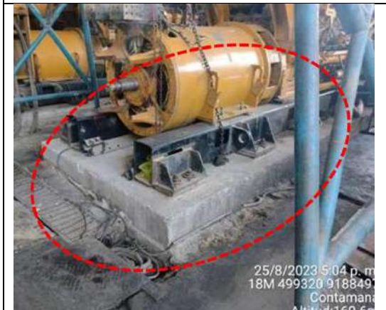
Fotografía N° 7 del Registro N°2025-E01-080290 Antes de las medidas , Grupo generador CAT-06-3516, sobre piso de concreto sin impermeabilizar y sin sistema de contención
