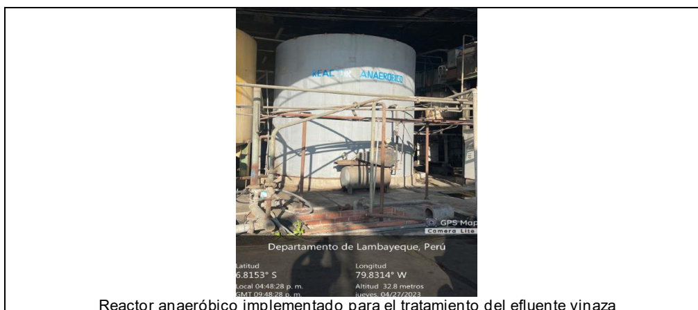
Reactor anaeróbico implementado para el tratamiento del efluente vinaza
