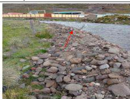
FOTOGRAFÍA N° 65.- (IMG_20220128_120854) Vista de la tubería de derivación que cruza el río Paratía con dirección al distrito
