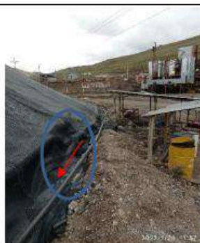
FOTOGRAFÍA N° 63.- (IMG_20220128_115944) Vista de la tubería de derivación al pie del depósito de relaves
