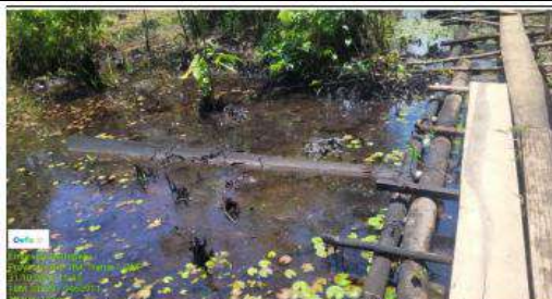
Fotografía N° 20: Vista del canal de flotación, como se observa a la vegetación impregnada con hidrocarburos e iridiscencia sobre el agua superficial (Coordenada UTM WGS84 18M: 339287 E, 9460911 N) Fuente: Acta de la Segunda Supervisión suscrito el 5 de noviembre de 2022
