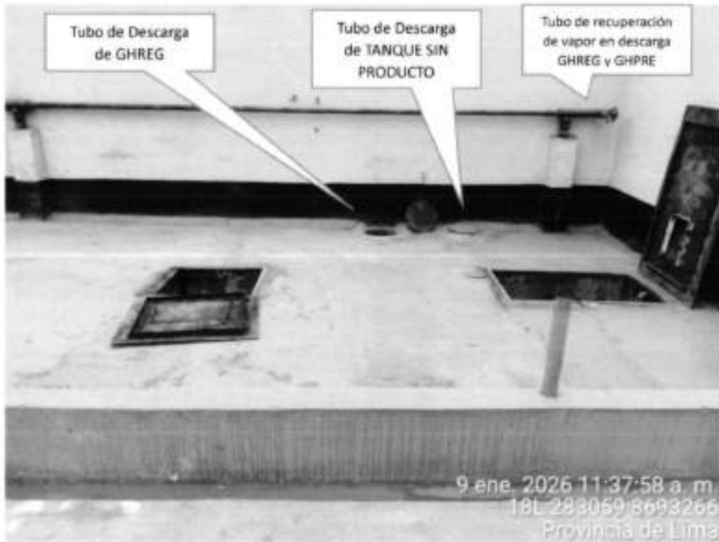
Foto N° 02: Vista tanque N° 3 y 4; Se verifica las tuberías de descarga distinta a lo aprobado en el EIA.
