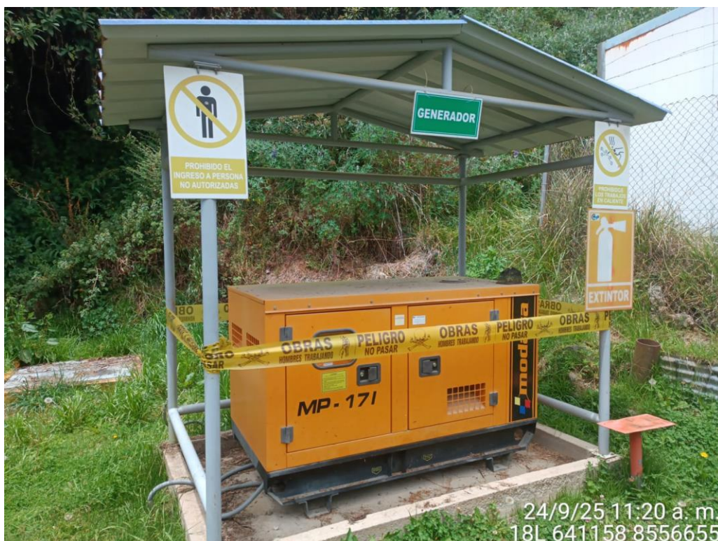
Fotografía 5-5 Vista del generador con base de concreto y techado
