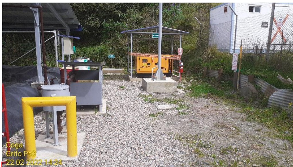
Fotografía 5-4 Vista lateral de la Estación de Abastecimiento Temporal donde se puede visualizar al fondo el generador
