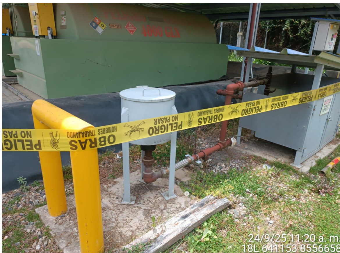
Fotografía 5-6 Vista de la electrobomba con base de concreto y techado
