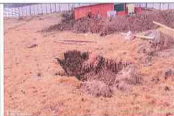
Fotografía N° 025: falta de señalización en el área excavada.
