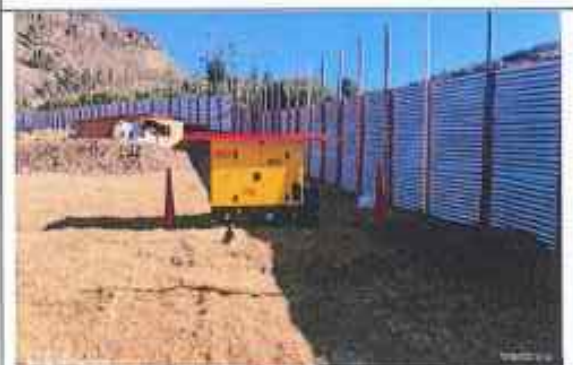
Fotografía N° 023: falta de barreras en el grupo electrógeno
