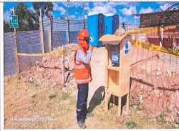
Fotografía N° 018: Verificación del punto de Hidratación.
