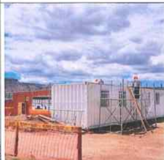
Fotografía N° 023: falta de uso de arnes
