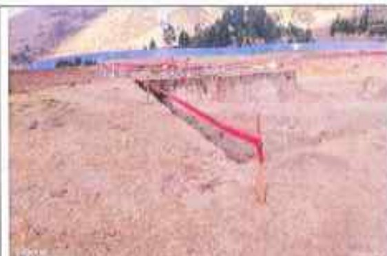
Fotografía N° 025: deficiente señalización en el área excavada.
