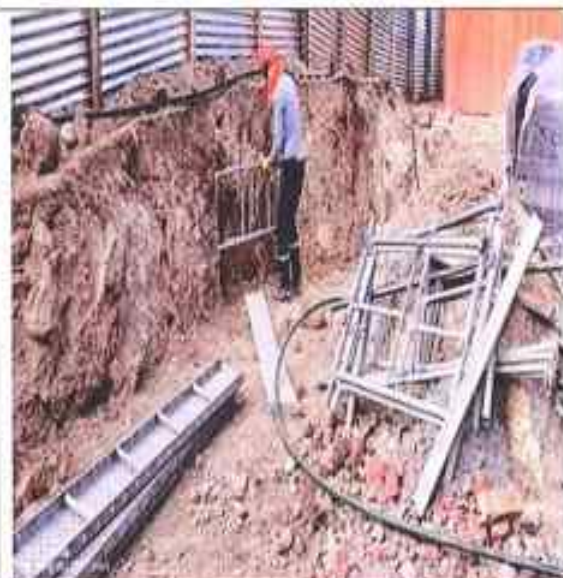
Fotografía N° 019: falta de orden y limpieza.
