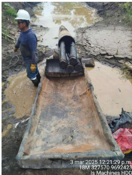
Vista de la distribución interna de la tubería de 16" de diámetro, se aprecia en su interior 4 tuberías de 4" de diámetro. Fotografía tomada el 3 de marzo de 2025.
