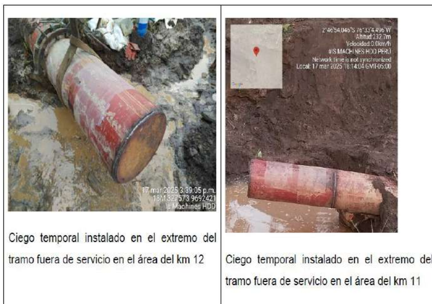
FIGURA 78: CIEGOS TEMPORALES INSTALADOS EN EL KM 11 Y EN EL KM 12 (CRUCE DEL RÍO PASTAZA)
