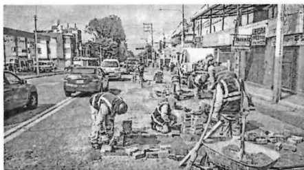
Las lluvias dañan seriamente la carpeta asfáltica.
